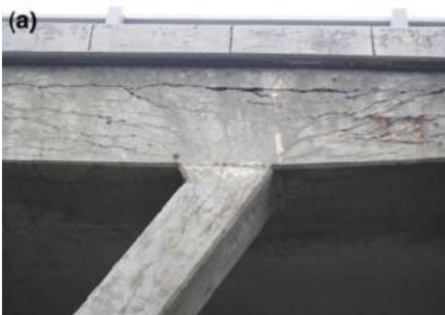
Foto 3. Näide ASR kahjustuse tagajärjel tekkinud peasarruse suunda järgivast pragunemisest sillakonstruktsiooni pinnal [35]
