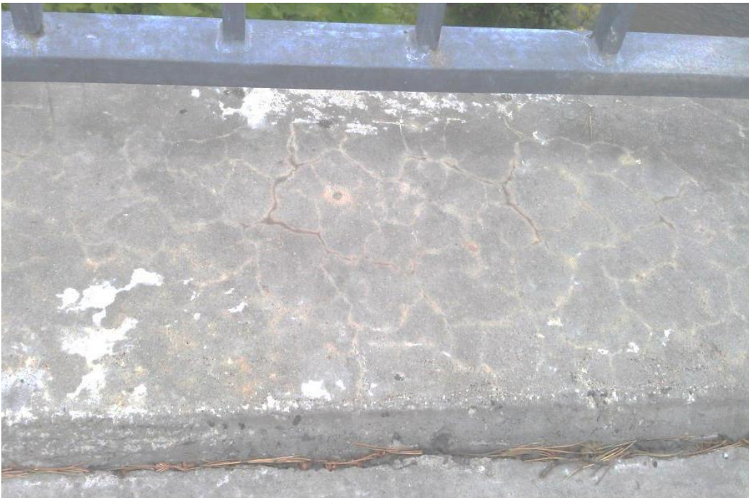
Foto 9. ASR põhjustatud võrkpraod Via Baltical asuva silla servaprussil [7]
