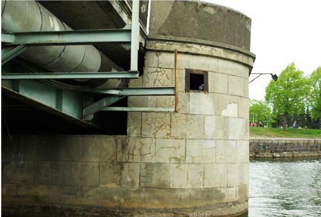
Foto 8. ASR kahjustusega 1970. aastatel ehitatud sild Lielupe jõel [7]
