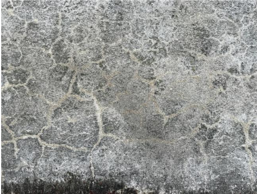
Foto 2. Näide ASR kahjustuse tagajärjel tekkinud võrkpragunemisest sarrustamata betooni pinnal [34]
