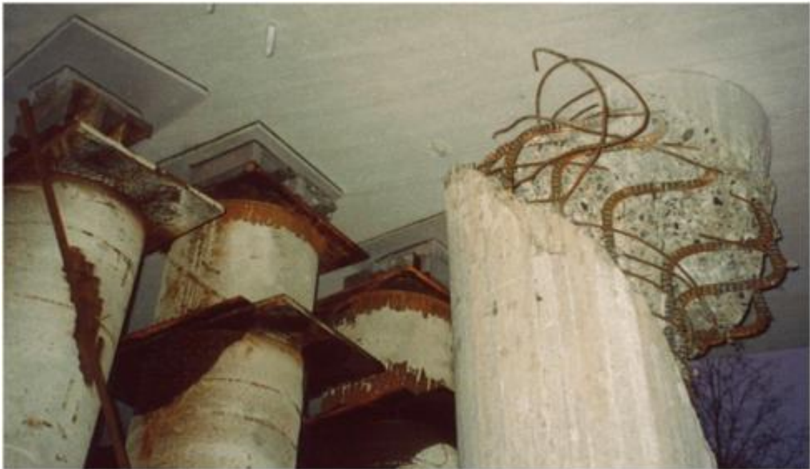
Foto 5. Raudbetoonist tugiposti otsa purunemine ASR mõjul pikenenud tekiplaadi tõttu
