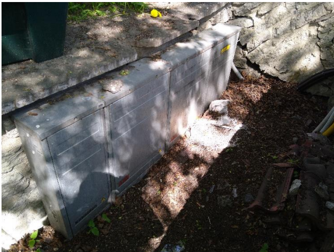
Foto 1. Kilbid ilma nõuetekohase tähistusega (unikaalne tunnus, elektriohumärk)
