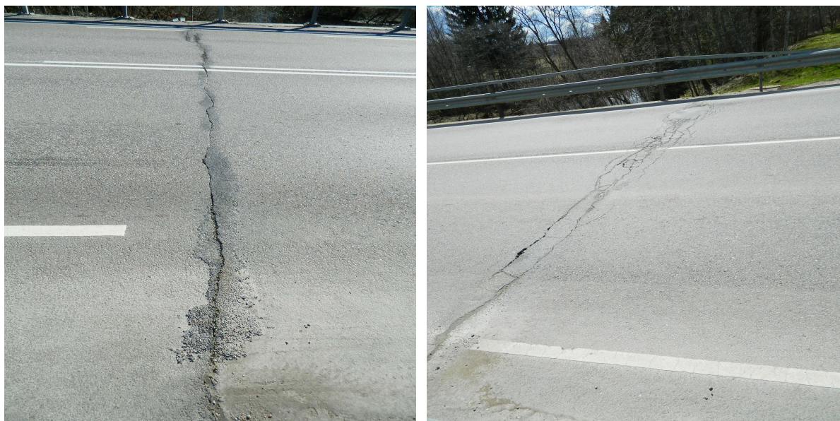
Joonis 41. Kaldasamba deformatsioonivuugi pragu kattес [erakogu]
