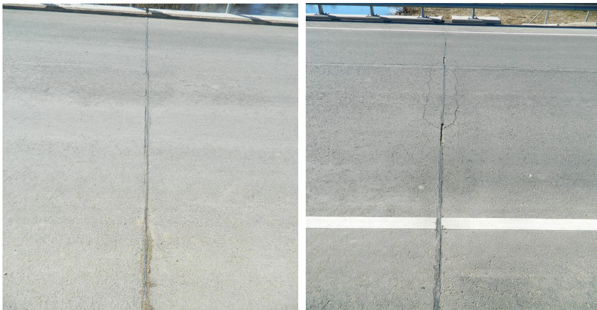
Joonis 40. Deformatsioonivuugi kohal kattesse lõigatud soone täite nakke kadumine kattega ning vuugi täitematerjali osaline kadumine soonest [erakogu]
