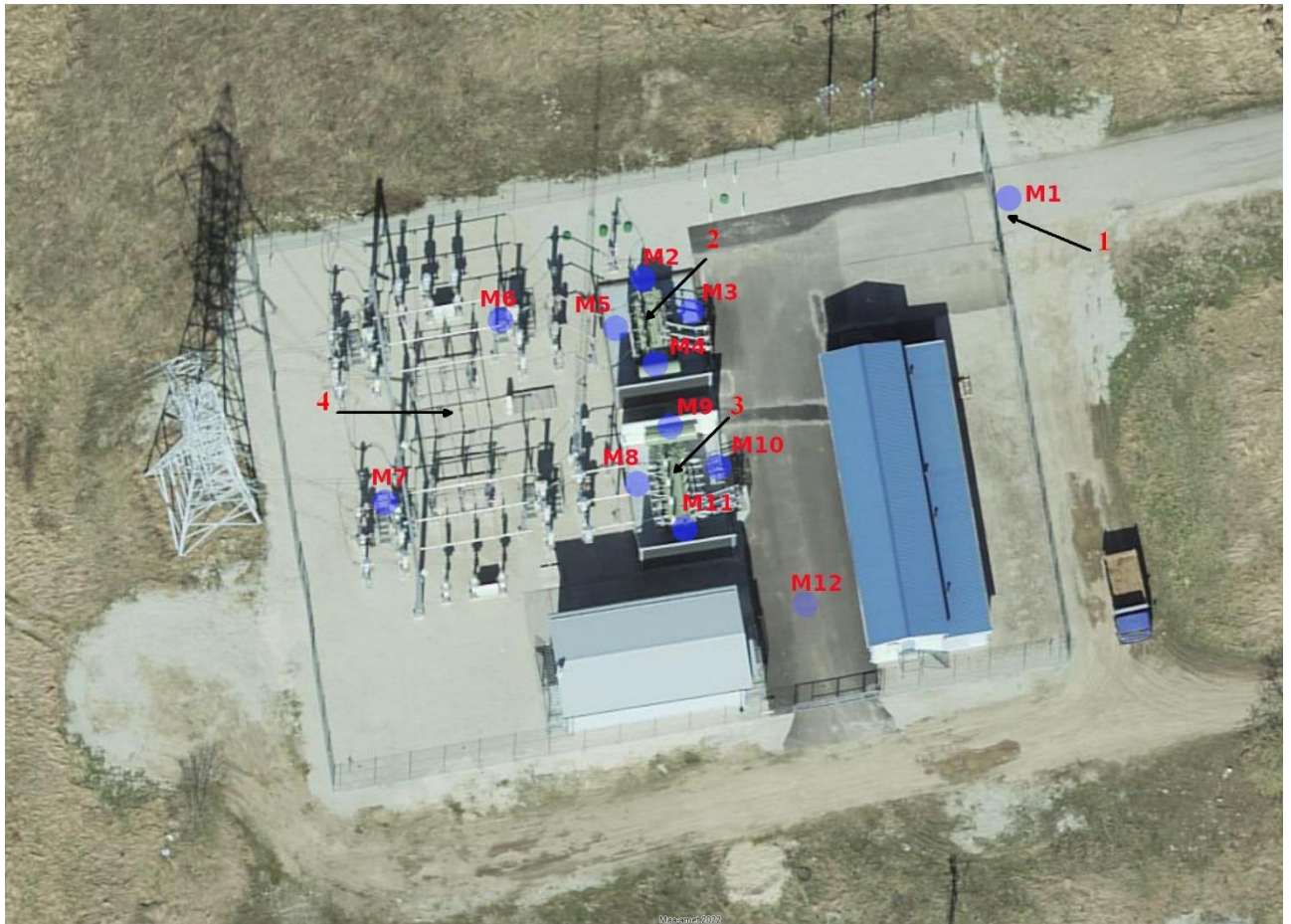
Joonis 11. Mõõtepunktid Tabasalu alajaamas: 1 – alajaama sissepääs, 2 – trafo C2T, 3 – trafo C1T, 4 – 110 kV liini lahtrid
