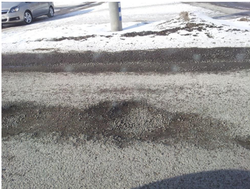
Foto 8. Tallinn, Tee nr 7950823 Sõpruse pst, murenemine bituumensideaine vananemise tõttu
