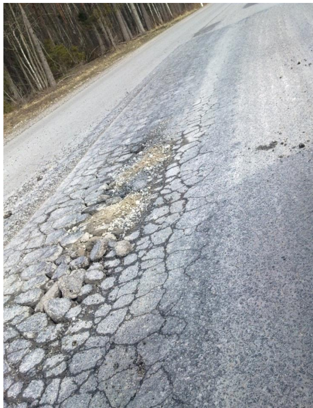
Foto 6. Harju-Risti - Riguldi – Võntküla 16km, Tee nr 11230, ühekihilise asfaltkatte võrkpraod [Erakogu]
