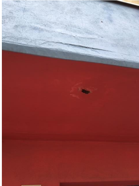
Foto 22. Hoone sissepääsu katuse lekkekoht
