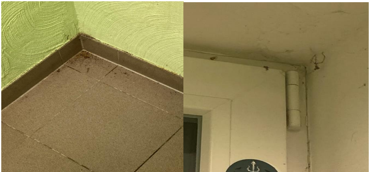
Foto 15. Puudused – trepikoja põranda nurk ja akna ümbrus
