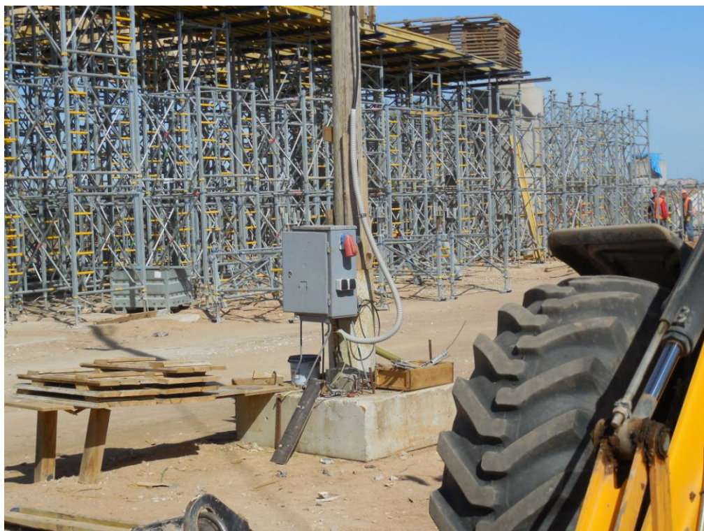
Joonis 7. Energiajaotusinstallatsioon välitingimustes Ihaste sillal [erakogu]
