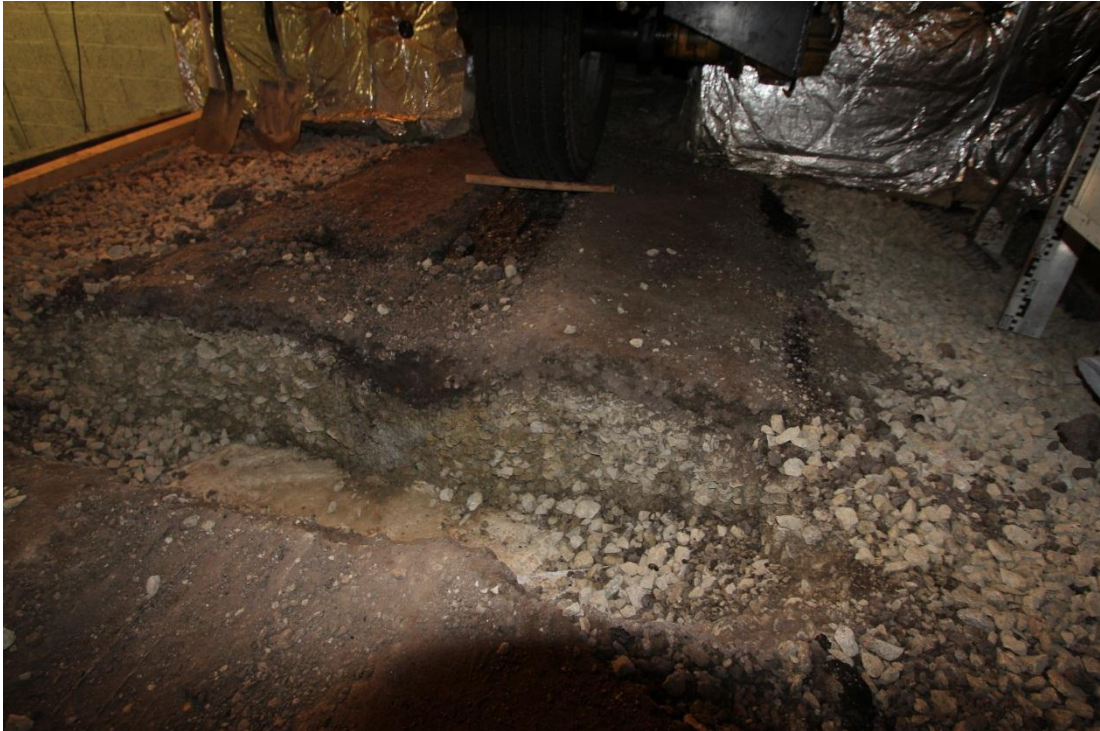
Foto 41. Killustiku purunemine konstruktsioonis [1]
