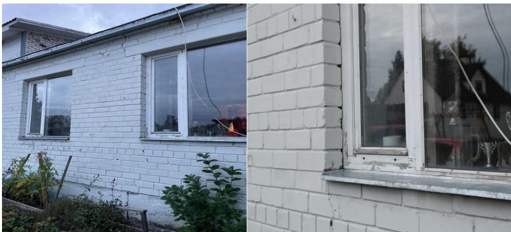
Foto 6. Akende ja aknaplekkide seisund
