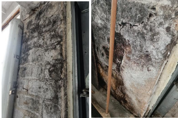
Foto 4. Kahjustus hoones seestpoolt
