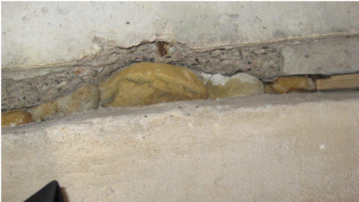
Foto 3. Truubi betoonkonstruktsiooni kaitsekihi kahjustus [9]
