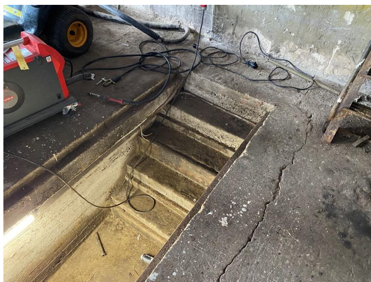
Foto 23. Kanalisse viiv betoontrepp
