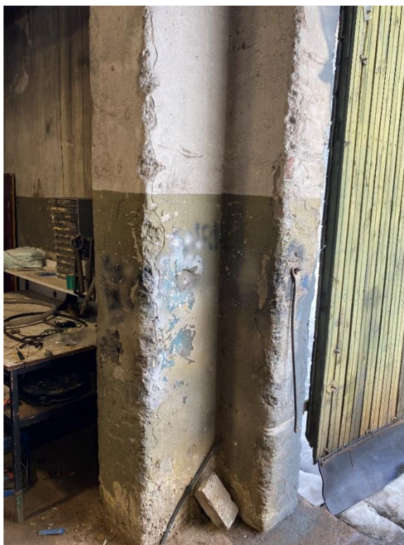
Foto 14. Kahjustatud krohvikihht telfri postidel
