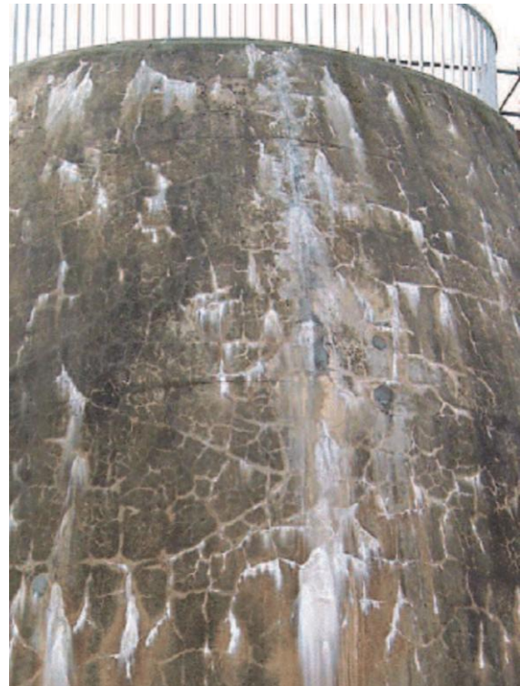
Foto 3. ASR kahjustustega betoonkonstruktsioon iseloomuliku võrkpragunemisega, pragudest väljub ASR-geel [8]
