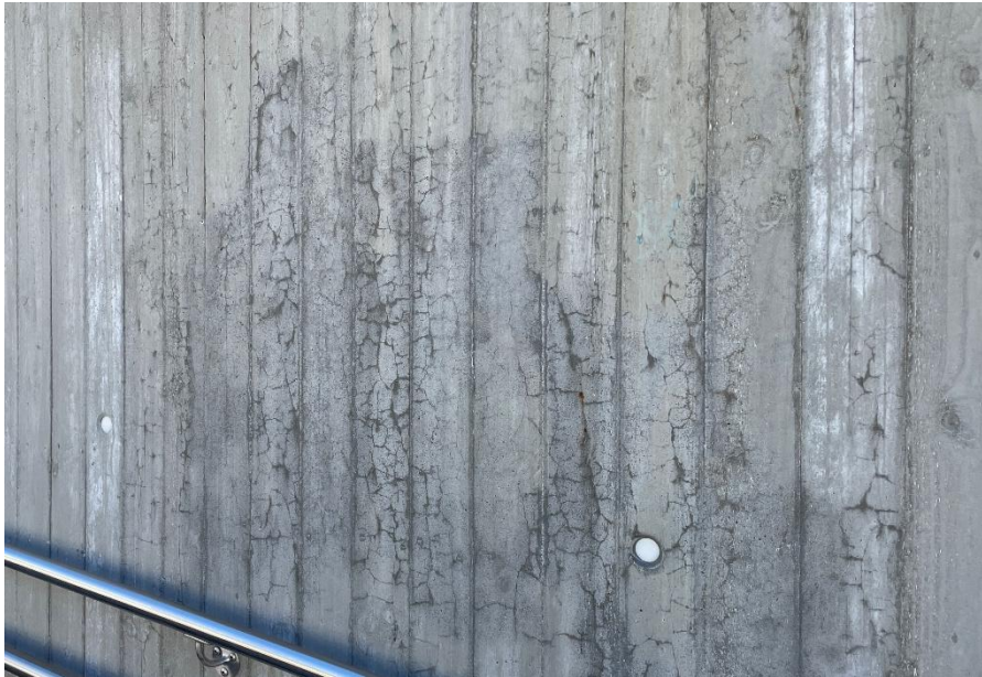
Foto 54. Objekt 4 tugiseina pragunemine
