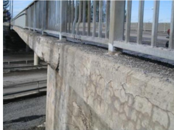
Foto 11. Tamperes Kokki silla servaprusside võrkpragunemine [14]
