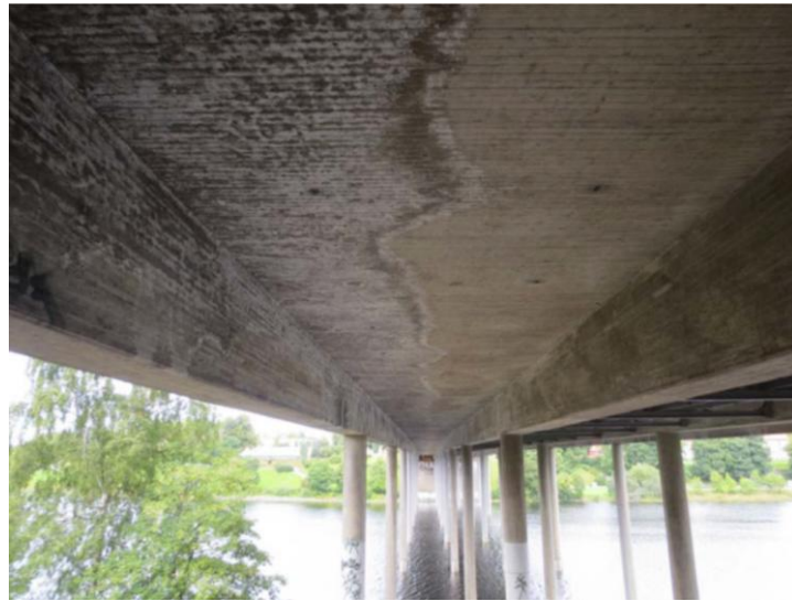
Foto 12. Sillateki alumise osa ASR-ist tingitud kahjustused [15]
