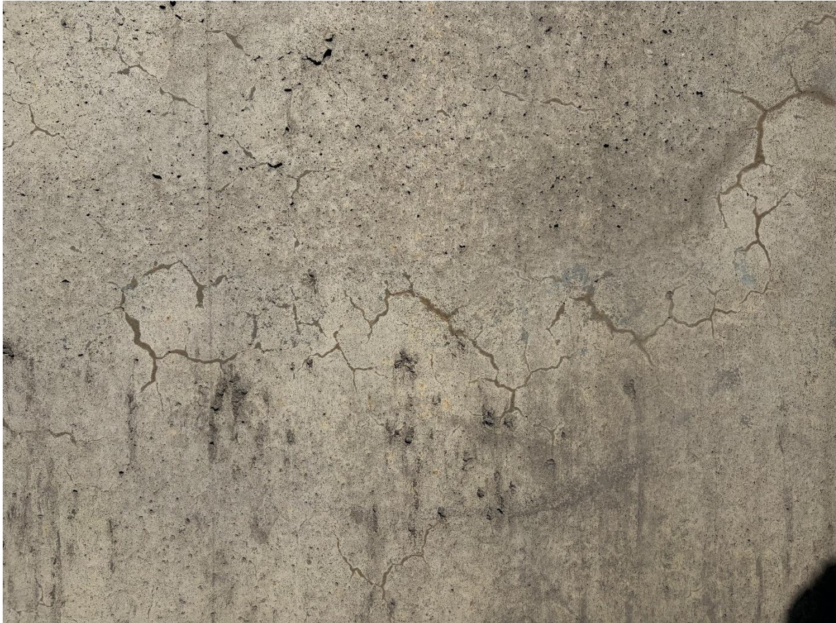
Foto 44. Objekt 2 tugiseina võrkpragunemine
