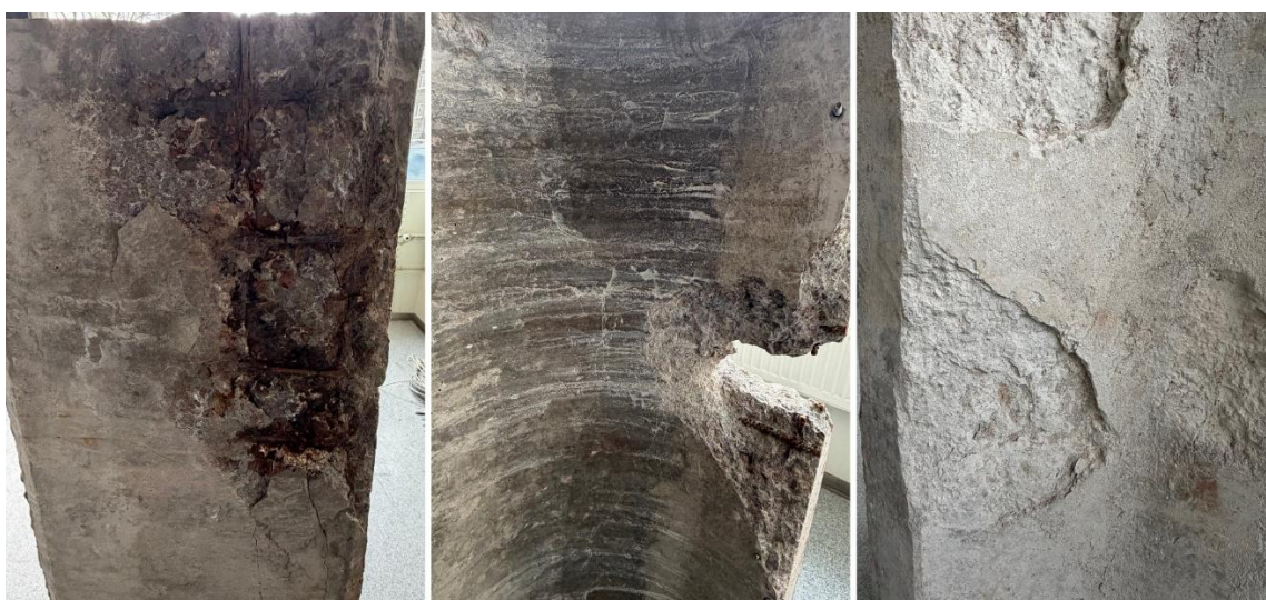
Foto 34. Sõpruse silla tükk nähtavate konstruktsiooni kahjustustega
