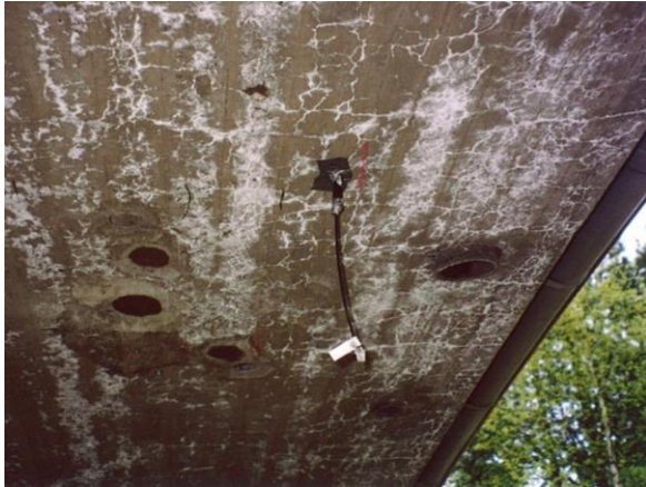
Foto 10. Paltanmäki silla ASR kahjustused [14]
