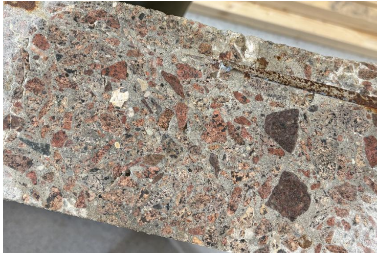
Foto 35. Destilleeritud veega puhastatud Sõpruse silla tala uuritav sektsioon
