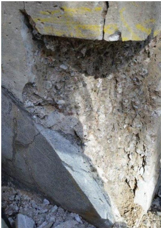
Foto 2. ASR kahjustused betoonkonstruktsiooni serval [7]
