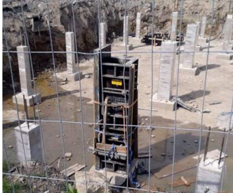
Foto 5. Lõhkenud vundamendipost (autori foto)
