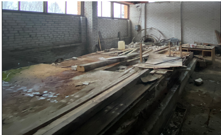
Foto 16. Põrand, tehnoloogiline sisseseade
