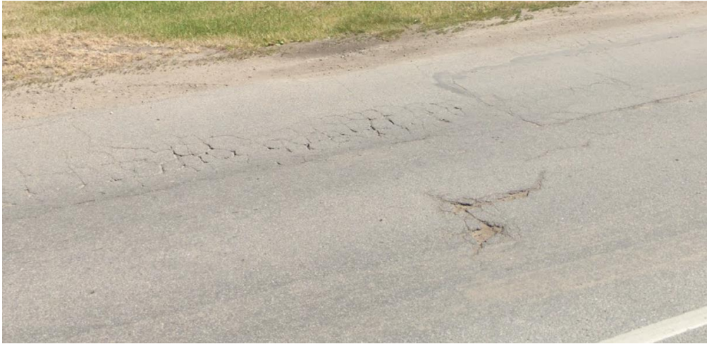
Foto 13. Sõpruse tänava võrkpragunemised
